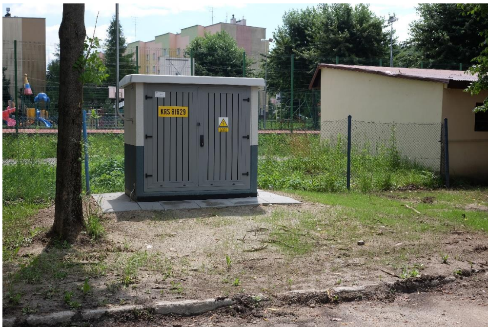
Złącze kablowe ZK-SN 15 kV pod inwestycję kogeneracyjną
