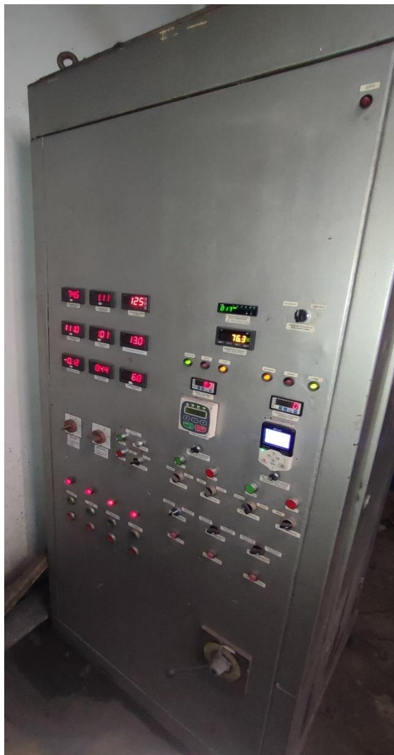
Zdjęcie 3. Szafa sterownicza kotła nr 2.
