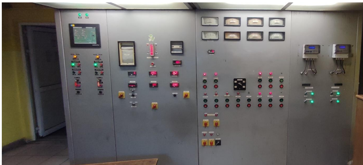
Zdjęcie 6. Szafa sterownicza AKPiA w pomieszczeniu sterowni.
