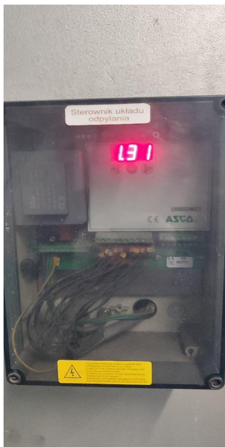
Zdjęcie 2. Szafka sterownicza układu odpylania kotła K1.
