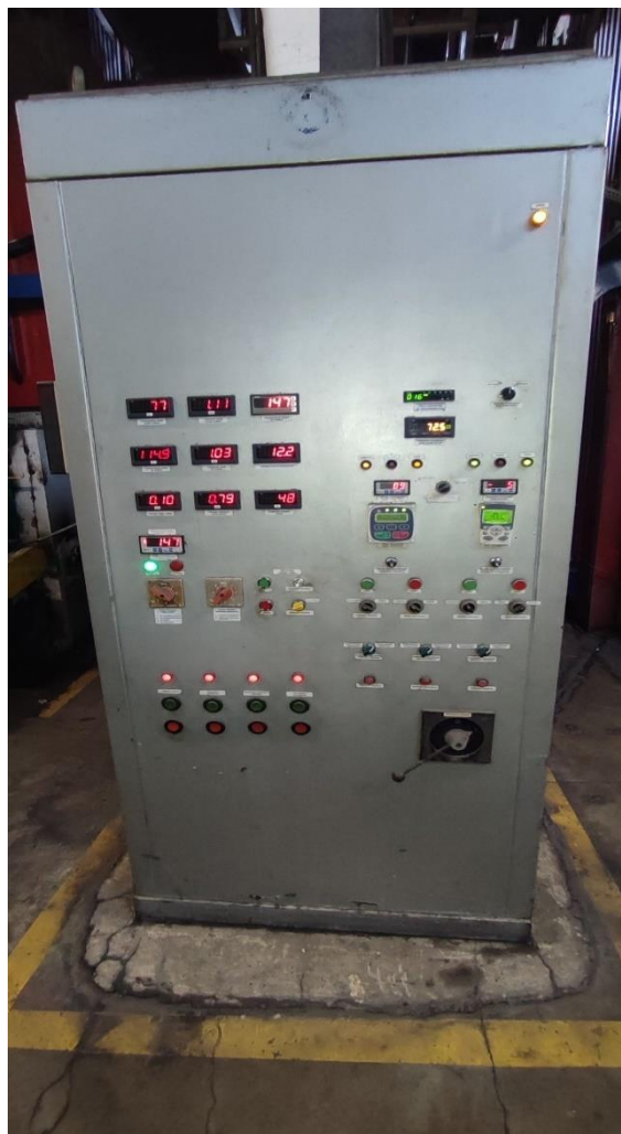
Zdjęcie 1. Szafa sterownicza kotła nr 1.
