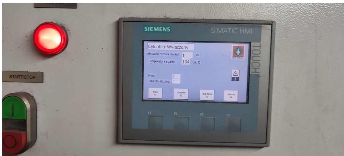
Zdjęcie 5. Panel operatorski Siemens KTP400 Basic.
